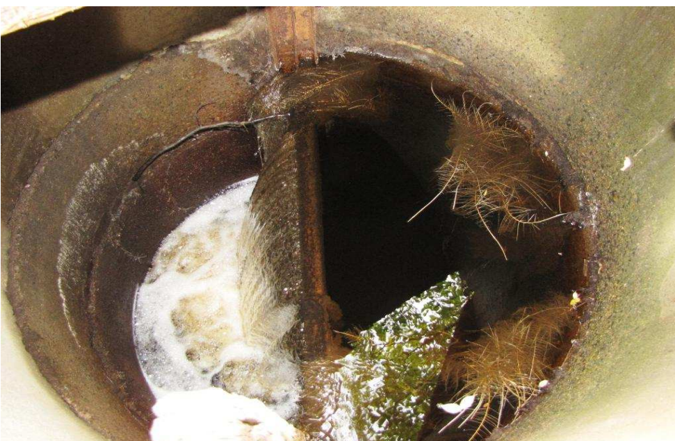
Huoltamaton munkkikaivo vaati kunnostusta. Kuva Reijo Kotilainen 20.7.2011
