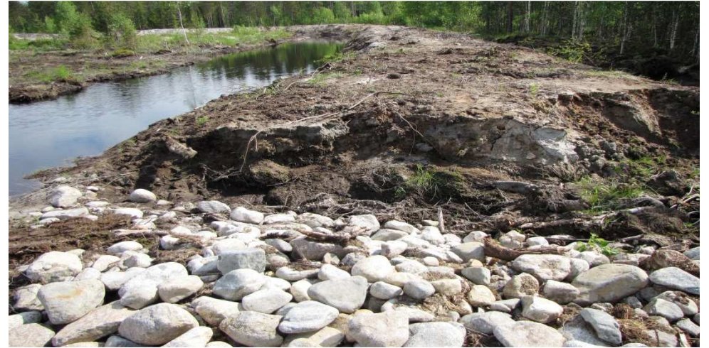
Märkä rakennussyksy ja kevättulva aiheuttivat sortumia rakennelmissa, joita jouduttiin kunnostamaan. Kuva Reijo Kotilainen 5.6.2013
