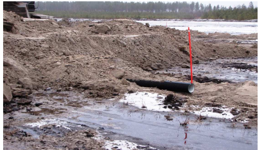
Kosteikkoa voidaan tyhjentää patovalliin asennettujen tyhjennysputkien avulla. Kuva Reijo Kotilainen 26.11.2014
