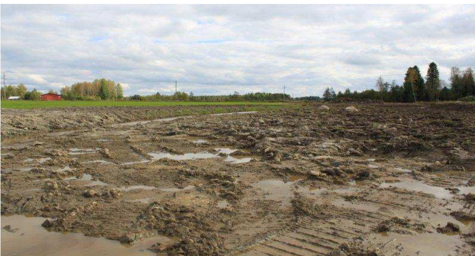
Kosteikko kaivettiin maanomistajan omana työnä. Maamassoja siirrettiin noin 15 000 m 3 . Kuva Ville Hokkanen 7.9.2011.
