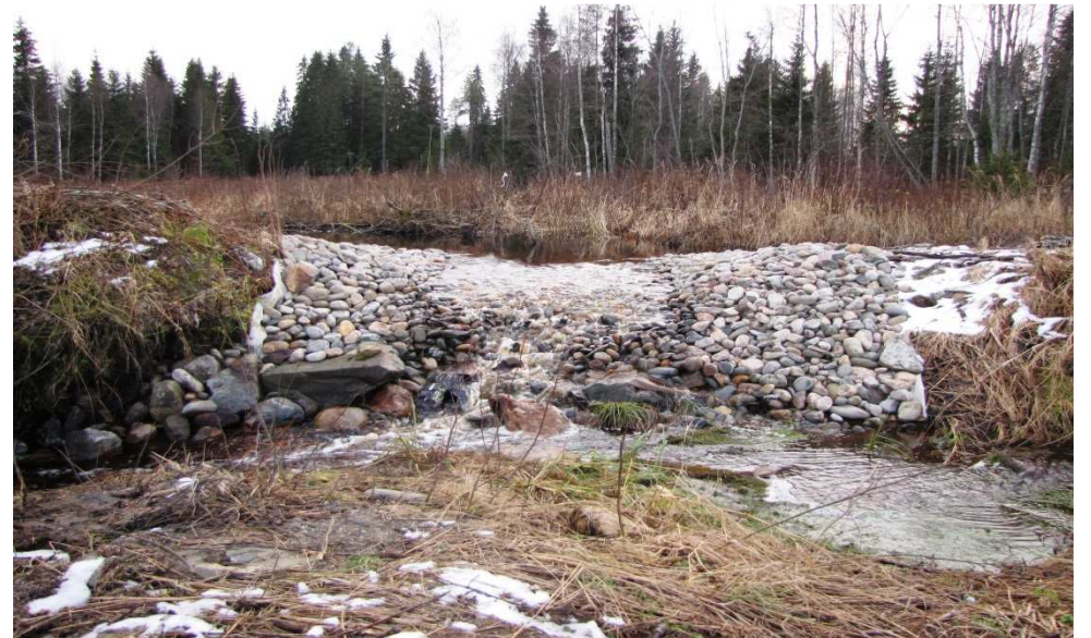
Pohjapato rakennettiin kiinteästä tiivisteosasta, jonka päälle padotuskorkeuteen asennettiin suodatinkangas. Pohjapato verhoiltiin kivillä. Kuva Reijo Kotilainen 5.6.2013
