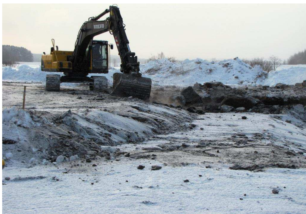
Pakkastalvesta johtuen jäädyttäminen onnistui turhankin hyvin, mikä asetti haasteita kaivutyölle ja kalustolle. Kuva Reijo Kotilainen 25.2.2011
