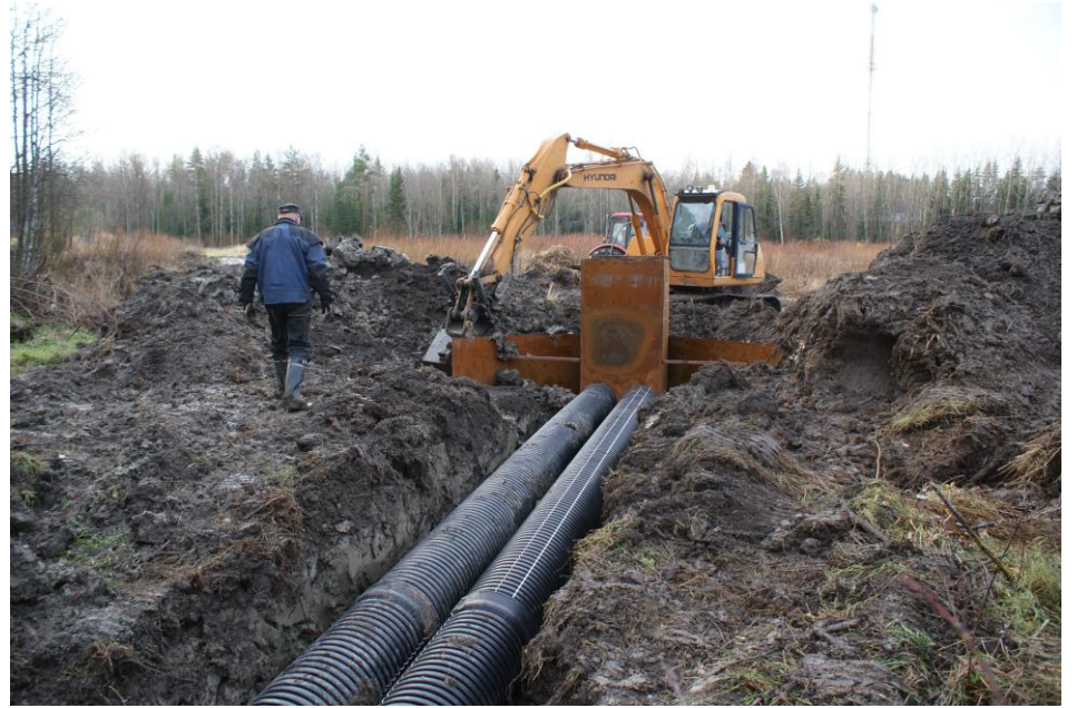
Säätelylaite sijoitettiin pellolta lähtevän ojan suulle. Rumpuputkina on kaksi 400 mm muoviputkea. Kuva: Jouni Tolvanen, marraskuu 2013
