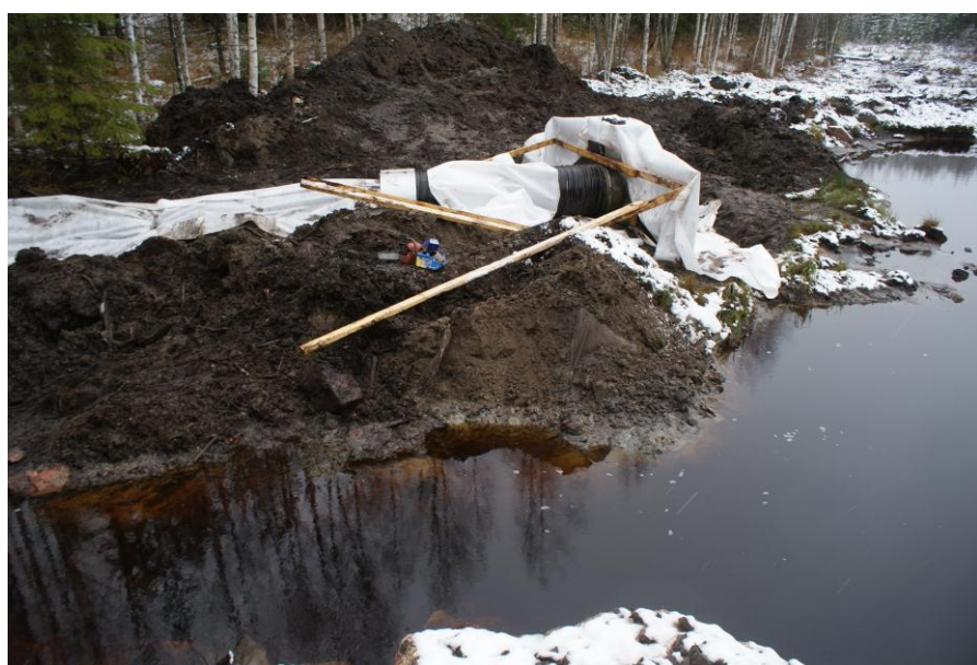
Säätelylaitteen paikka jouduttiin siirtämään korjauksen yhteydessä vanhan uoman viereen, jotta asennus voitiin tehdä kuivatyönä. Paikan muutoksen takia jouduttiin rumpuputkea jatkamaan. Kuva: Jouni Tolvanen, marraskuu 2012.
