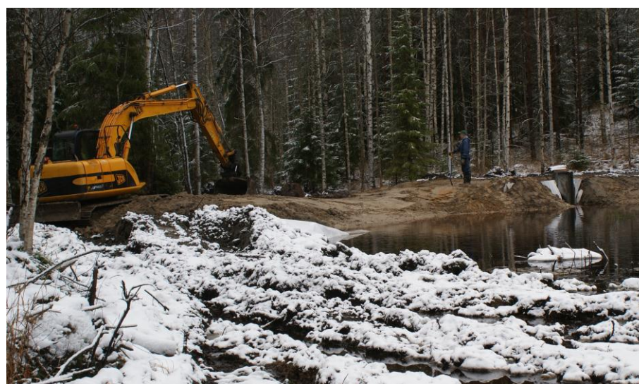
Tulvakynnys tehtiin vanhan uoman kohdalle ja kivettiin seuraavana kesänä. Käytettävissä ollut maa-aines oli hyvin hienojakoista, joten patopenkkaa vahvistettiin maanrakennuskankaalla. Kuva: Jouni Tolvanen, marraskuu 2012.
