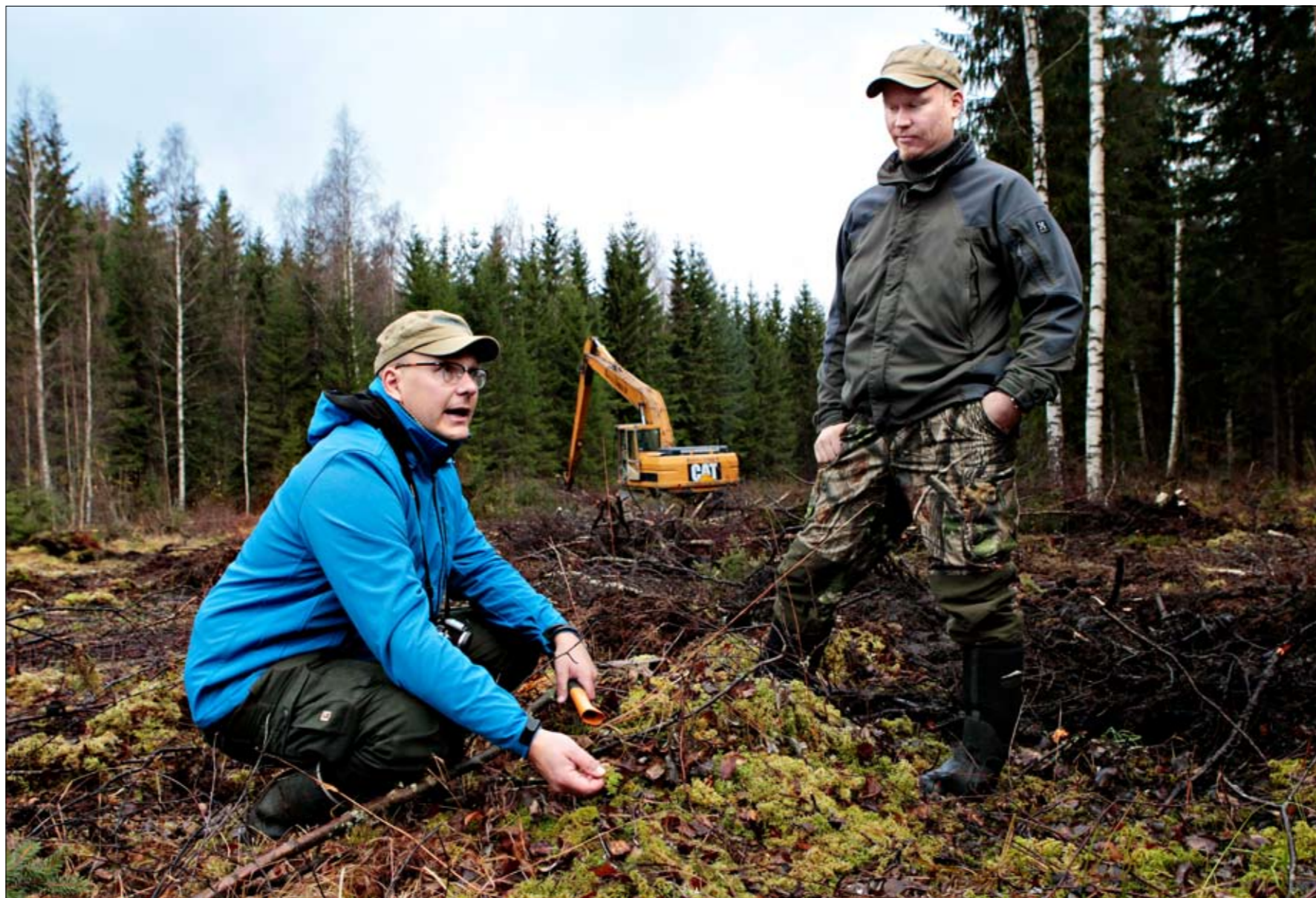
Veli-Matti Pekkarinen (vas.) lupaa, että nyt rujan näköisellä paikalla on ensi kesänä kosteikko täynnä elämää. Oikealla Teemu Lamberg, kaivinkoneen puikoissa Teemu Kiiski.
